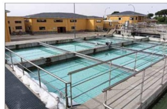
FIGURA 17. Decantador con lamelas WssDynamics en la ETAP de Griñón.
