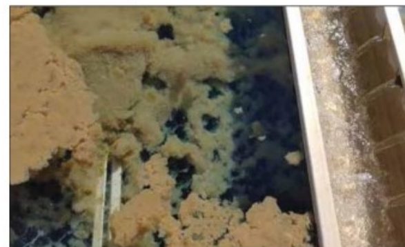
FIGURA 8. Flóculos escapando del decantador.
