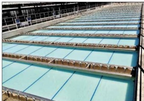
FIGURA 5. Nuevo modelo de lamelas instaladas en el decantador D en funcionamiento.
