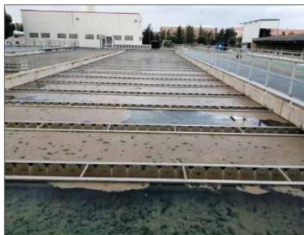
FIGURA 11. Estado del decantador cuando se produce pérdida de eficacia por caudales elevados.
